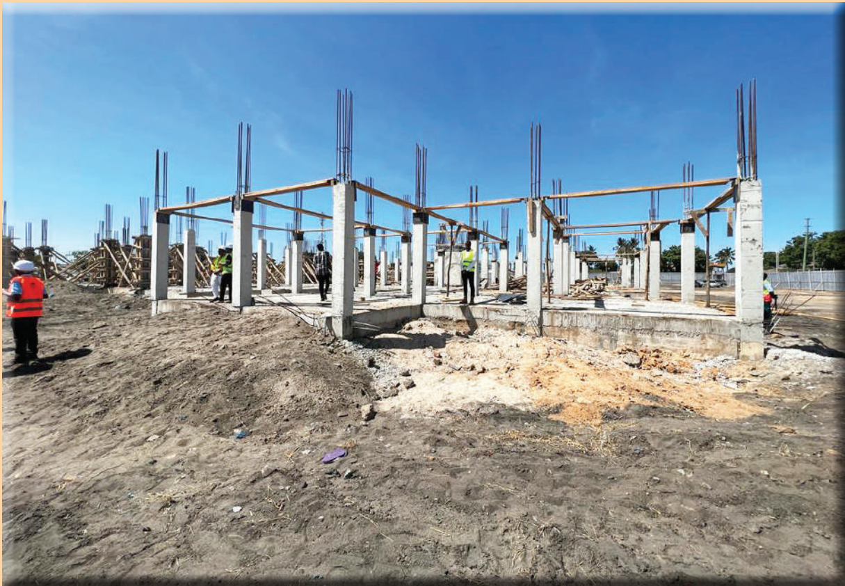
Muonekano wa Mradi wa Ujenzi wa nyumba za makazi ya watumishi wa umma katika eneo la Temeke Jijini Dar es Salaam unaotekelezwa na TBA kama Mkandarasi na Mshauri Elekezi.
